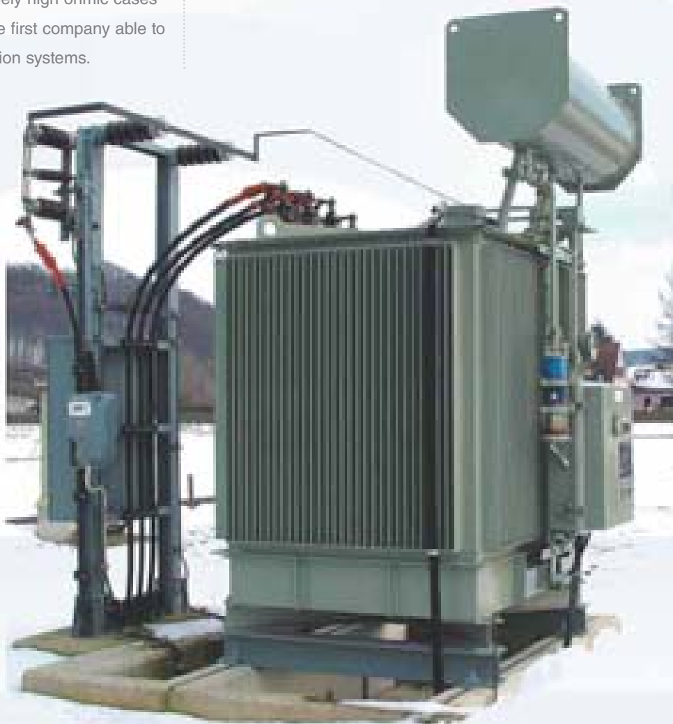
ASC 20kV, 5000 KVar
