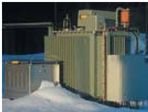
ASC 10kV, 400 KVAR
