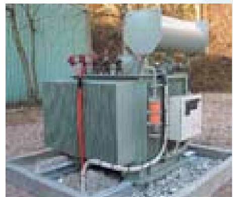
ASC 10kV, 1000 KVAR
